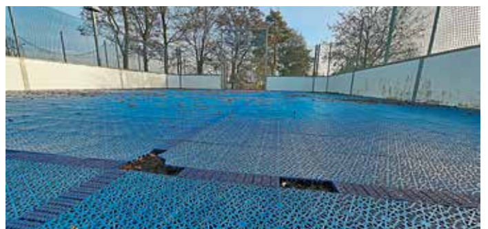
Fun Arena mit defekter Bodenplatte
